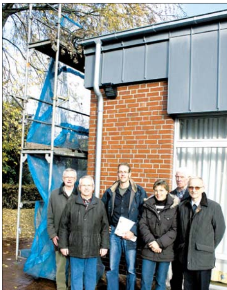
Die Dachsanierung in St. Johannes Rheda geht ihrem Ende entgegen. Auf trockene Zeiten freuen sich (v. l.) Pfarrgemeinderatsvorsitzender Franz-August Böcker, Bruno Merschmann (Kirchenvorstand), Architekt Matthias Nopt, Martina Mettenberg und Bernhard Witte vom Kirchenvorstand und Pfarrer Witold Szmigielski. Bild: Dresmann
