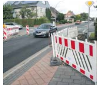
Kleinbaustellen: Wie hier an der Ringstraße wird derzeit an vielen Orten im ganzen Stadtgebiet gebaut. FOTO: MARION POKORRA-BROCKSCHMIDT
