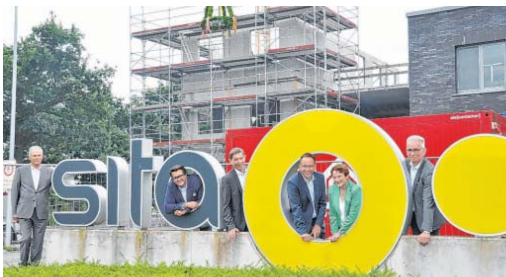
Vor dem Neubau: Firmengründer Karl-Heinz Gelsen (v.l.), Architekt Jens Weyers, Aurea-Geschäftsführer Günter Kozlowski, Bürgermeister Theo Mettenborg, Hildegard Haggenny (stellvertretende Bürgermeisterin Herzebrock-Clarholz) und Thomas Kleinegees feiern Richtfest.
